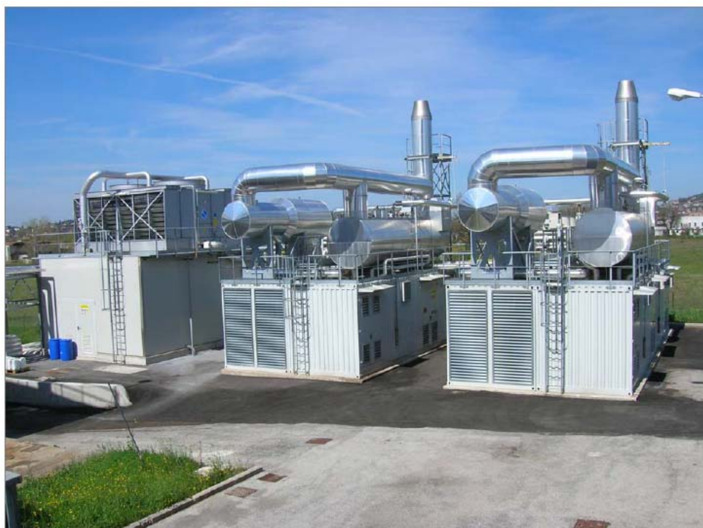
Immagine di un impianto di Tri-generazione alimentato ad olii vegetali
